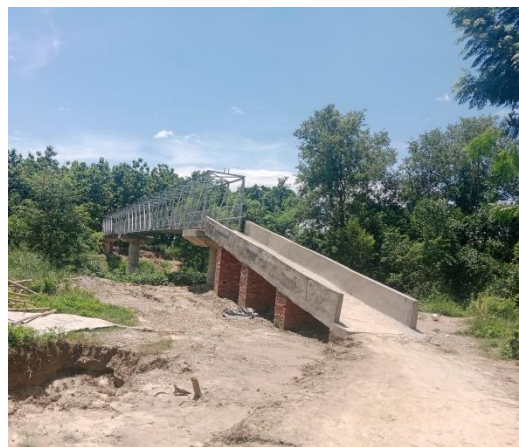
यस वर्ष निर्माण सम्पन्न बर्दघाट नपा अर्न्तगतको नारायणचोक गंगाबस्ती मल्टी स्पान टस बृज
